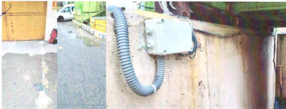
Líneas eléctricas de edificios y de instalaciones de ecoparque (tolva/compactadora)
